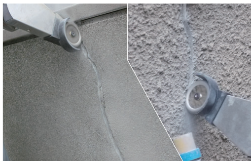
コンクリート外壁Uカット (Uカット溶着ダイヤモンドU50 使用)
